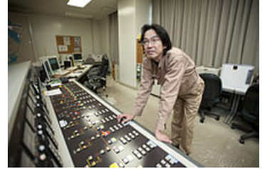
橫須賀美軍基地的SCADA控制室
